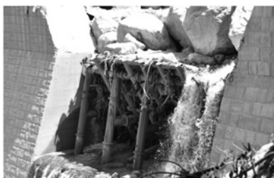
写真-1 鋼製堰堤の土石流捕捉事例（一部部材が破壊）
