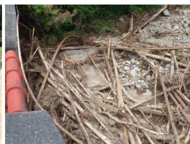
写真 8 新所 2 (堆砂状況)
