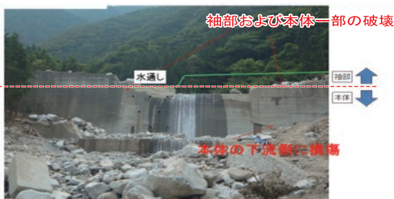
写真-1 コンクリート砂防堰堤本体および袖部の破壊 Photo 1 Collapse of concrete dam body and wing
