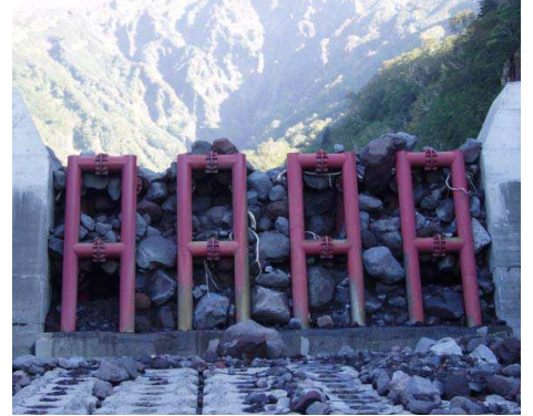
写真-1 雄忠志内川の砂防堰堤の礫捕捉状況 1)
