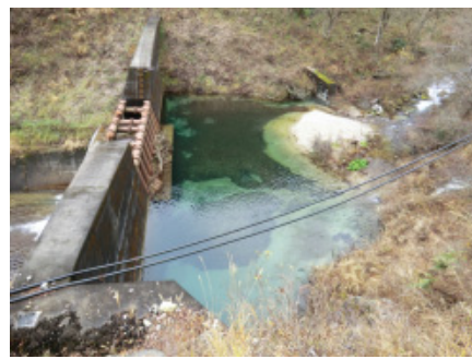
写真-2 不透過部が未満砂及び湛水した状態
