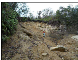
(a)崩壊源頭部(No.15 付近)
