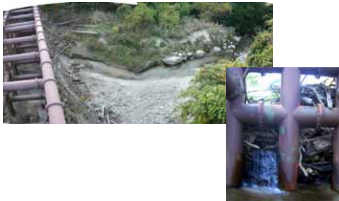
写真3 泊野川堆砂状況
