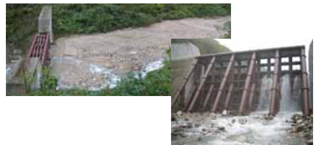
写真1 最下流えん堤による土石流の捕捉
