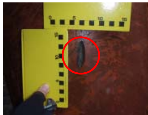
写真 1 最上流部材の損傷の例 (船石川)
