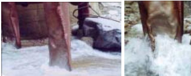
写真3 底版近傍の鋼管柱のへこみの例(阿木川)
