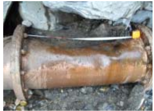
写真4 礫落下による部材の損傷例(大津谷)
