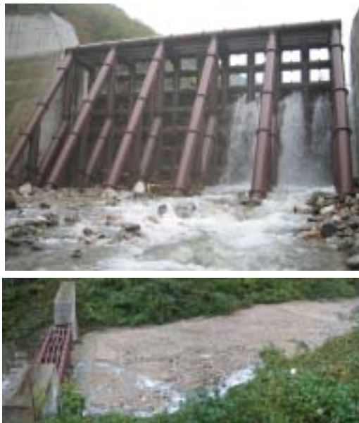
写真 1 土石流捕捉事例
