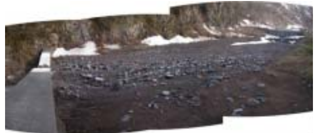
写真-2 本えん堤の上流堆砂状況
