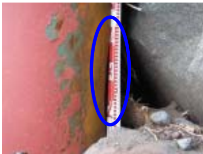
写真-5 ユニット4の損傷状況
