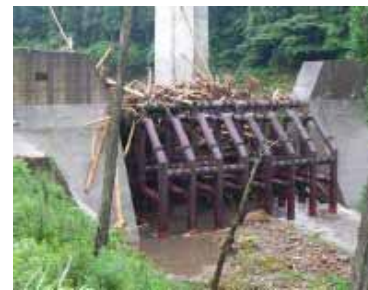
写真1 土石流・流木捕捉事例
