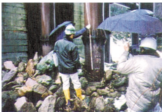
部材の損傷調査(最上流部水際部の鋼管損傷)
