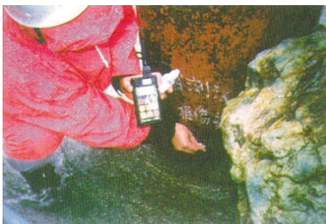
部材の損傷状況(水際部の鋼管損傷)
