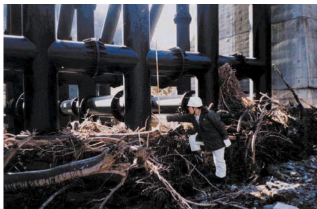
流木捕捉・腐食調査状況( 捕捉による損傷調査 )
