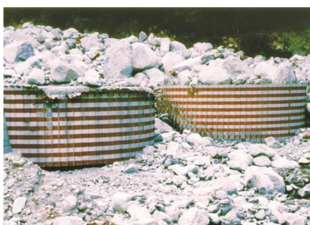
与田切川 鋼製セルえん堤の損傷 [天竜川上流工事事務所]
